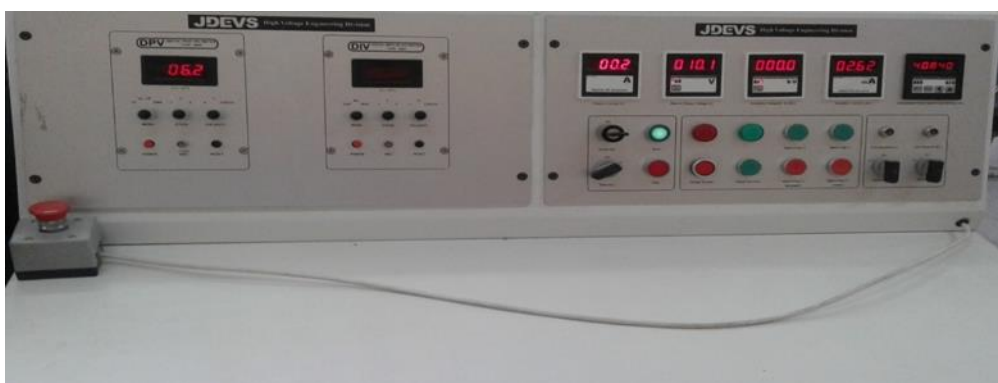
شکل ۳-۱۷- تابلو کنترل جهت کنترل و اعمال ولتاژ.
