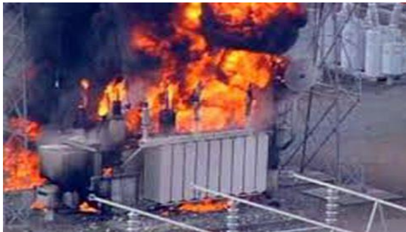
شکل ۱-۱- آتش‌سوزی ترانس‌های برق خوزستان بر اثر جریان نشتی مقره‌ها.
