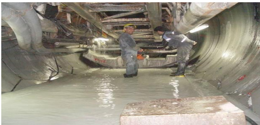
شکل ۴-۳: جریان آب زیاد در کف تونل و صعوبت کار برای پرسنل در قطعه دوم تونل انتقال آب قمرود [۶۰]
