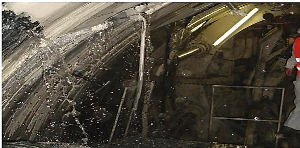
شکل ۲-۴: ریزش آب از دیواره‌های تونل و صعوبت کار برای پرسنل در تونل انتقال آب زاگرس [۶۰]
