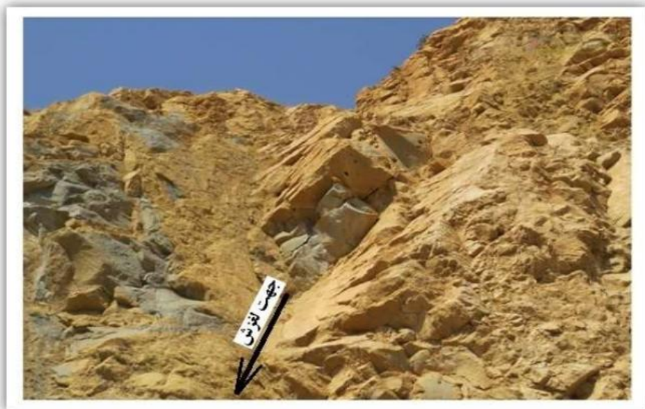
شکل ۲-۲: لغزش گوه‌ای شکل در ترانشه‌های جاده تنگه قیر (شمسی، ۱۳۹۳).
