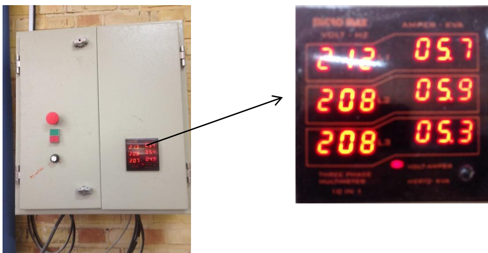
شکل ۵-۹- آمپرسنج دیجیتال برای ثبت تغییرات شدت جریان مصرفی و تابلو برق دستگاه برش سنگ
