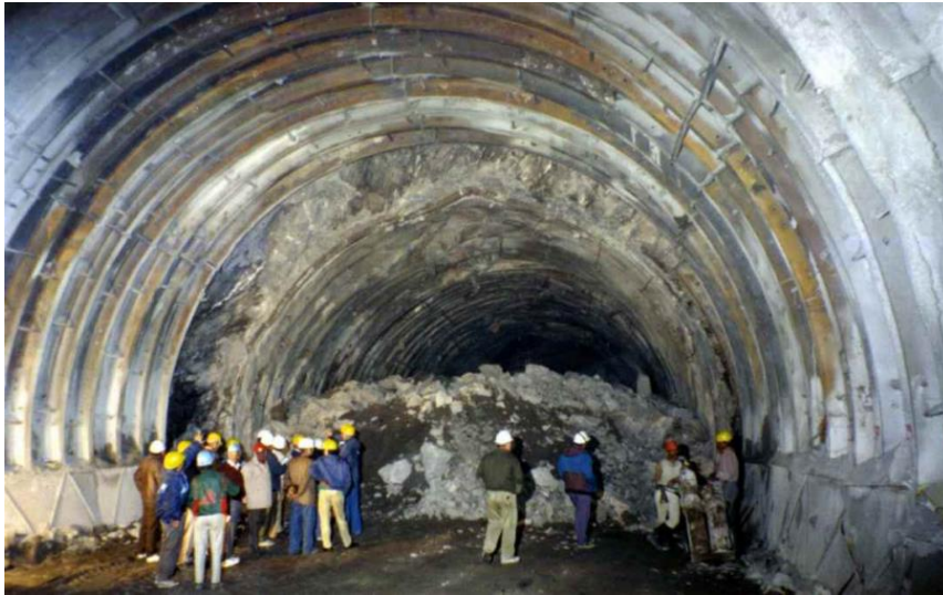
شکل ۲-۲: مچاله‌شوندگی شدید در تونل انتقال آب در پروژه نیروگاه برق آبی ناتپاجاگری ۱ در هند (Hoek & Marin, 2000).
