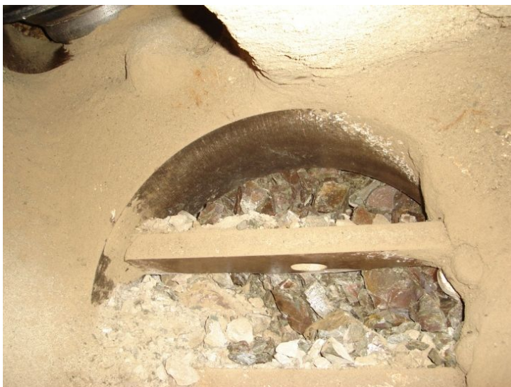
شکل ۴-۱- ریزش توده‌سنگ خرد شده روی کاترهد (تونل کرج ۱)
