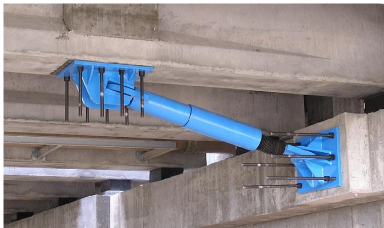
تصویر ۱-۳- استفاده از جاذب های ارتعاشاتی برای کنترل ارتعاشات پل
