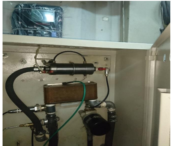
الف) تابلو سامانه پایش وضعیت روغن
