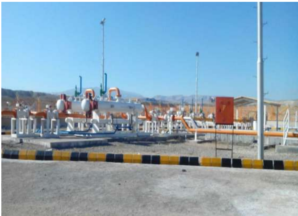
شکل ۱-۱ نمایی از ایستگاه تقلیل فشار شماره دو شهر بجنورد
