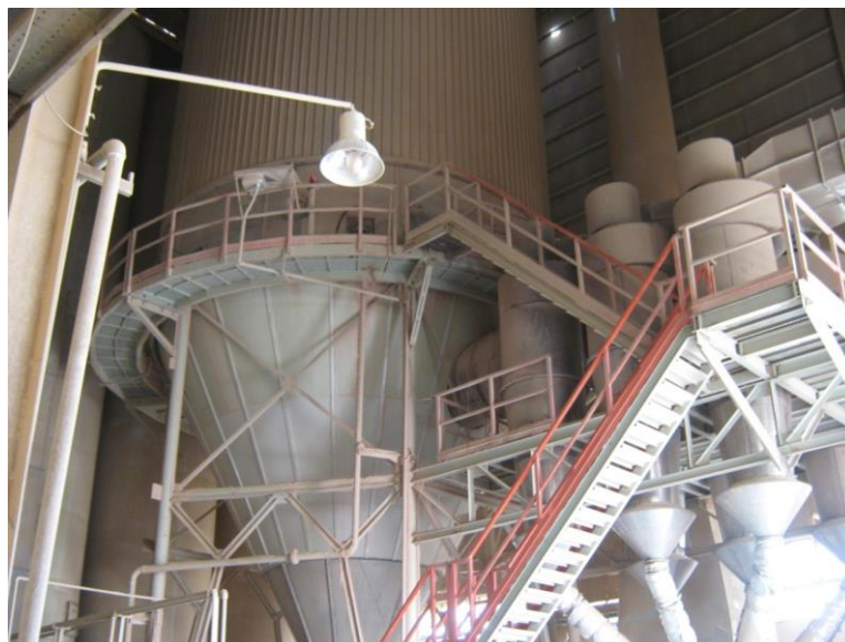
شکل ۱-۱: نمایی از خشک‌کن استوانه‌ای و تجهیزات جانبی به ارتفاع ۲۵ متر
