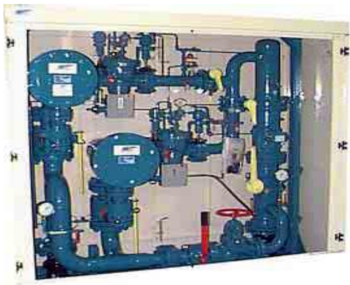
شکل ۴-۱/ ایستگاه گاز کابینتی [1]
