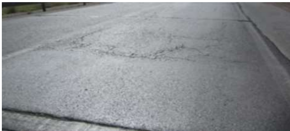
شکل ۲-۳. مسیر بافت - جیرفت (کیلومتر ۵۰ خرابی: ترک برودنی جزئی، نیمه، کامل، چندگانه)
