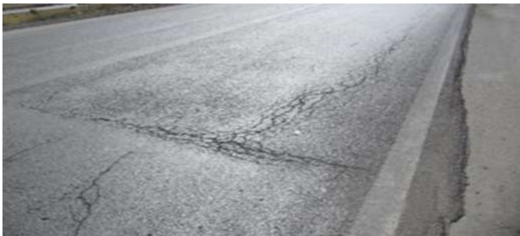
شکل ۳-۳. مسیر جیرفت - بندرعباس (کیلومتر ۹۰ خرابی: ترک برودتی چندگانه - ترک طولی)
