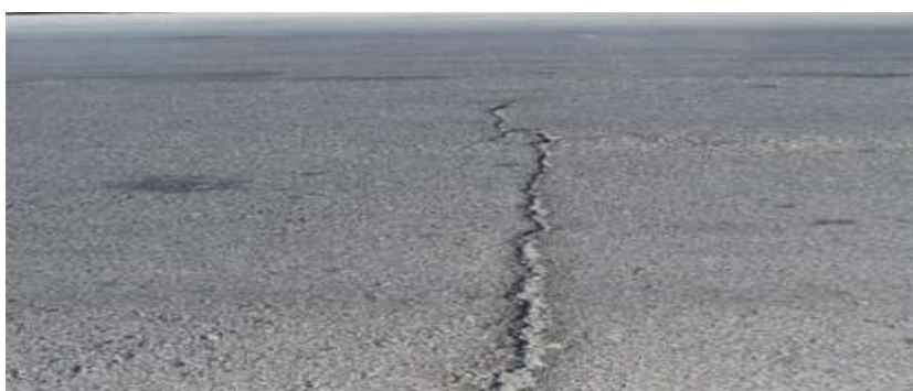
شکل ۳-۱. مسیر جیرفت - بافت (کیلومتر ۷۰، خرابی: ترک برودتی کامل)
