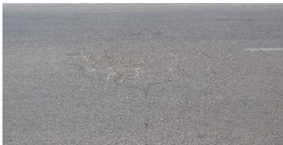
شکل ۳-۵. مسیر جیرفت - کرمان (کیلومتر ۱۵۰ خرابی: ترک برودتی چندگانه)
