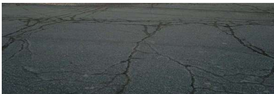
شکل ۳-۶. مسیر محور هراز (کیلومتر ۱۵ خرابی: ترک برودتی نیمه و کامل + ریز اطراف ترک طولی ترک بلوکی)
