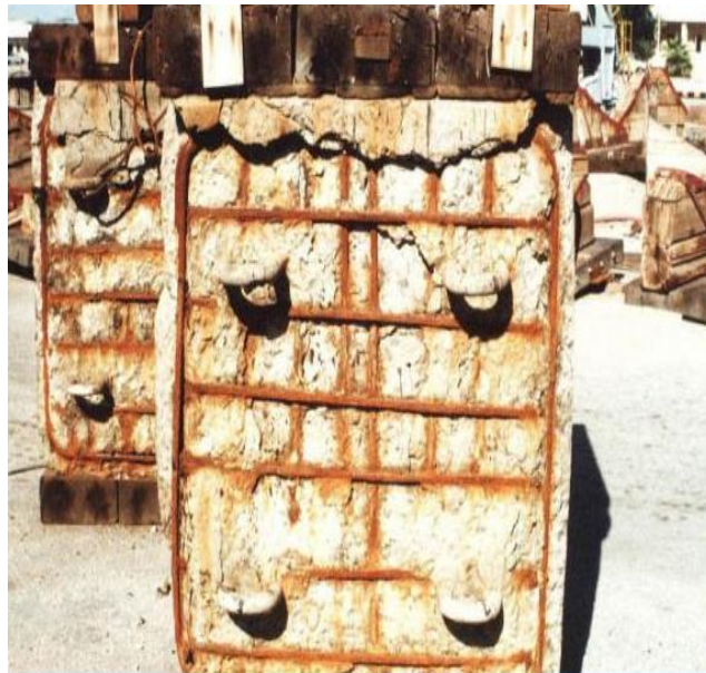
شکل ۲-۲: خسارت وارده به اعضای بتنی ناشی از خوردگی [۱۱]
