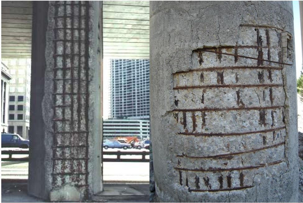
شکل ۲-۱۶- خورده شدن آرماتورها باعث کنده شدن پوشش بتنی شده است. [۱]
