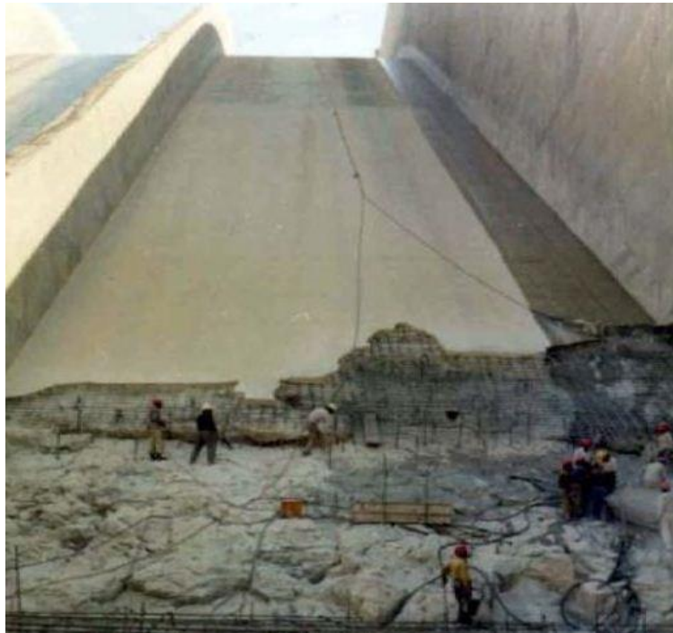
شکل ۲-۵ تخریب در سرریز سد کارون یک
