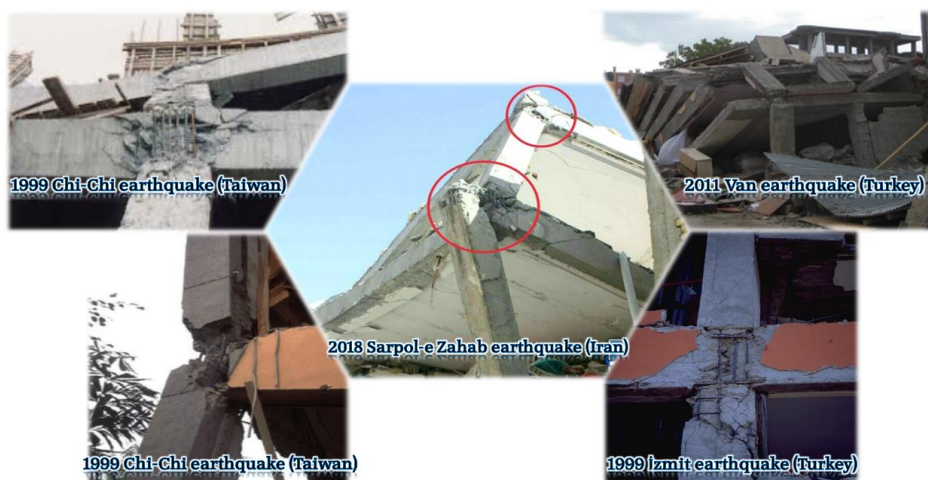
شکل ۱-۱: اتصالات آسیب دیده‌ی تیر-ستون بتن مسلح در زلزله‌های گذشته [۳-۵]
