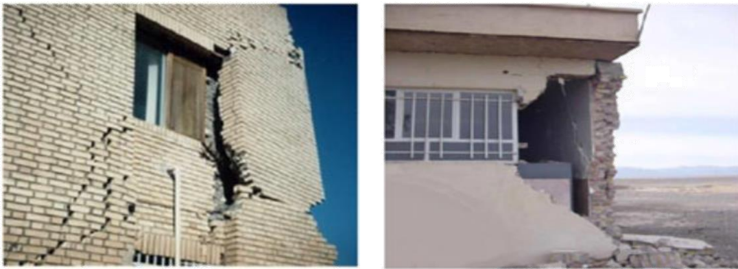
شکل ۵-۱. آسیب دیوارهای مصالح بنایی نتیجه اندرکنش داخل و خارج از صفحه [۸۴]
