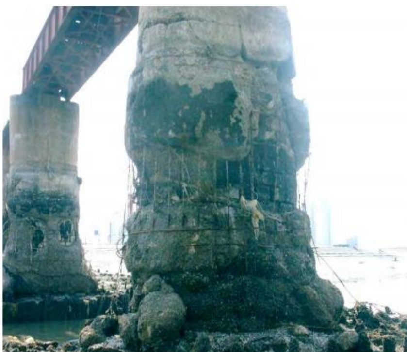
شکل ۱-۴: خوردگی در پایه‌های پل [۵]
