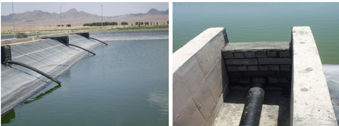
شکل ۳-۱۰: کانال سرریز و لوله‌های ۲۰۰ میلی‌متری کاروگیت انتقال جریان
