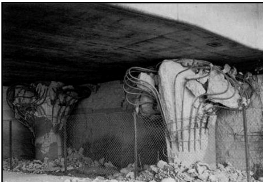
شکل ۱-۳- خرابی پایه یک پل در لس آنجلس به دلیل کمبود آرماتورهای عرضی
