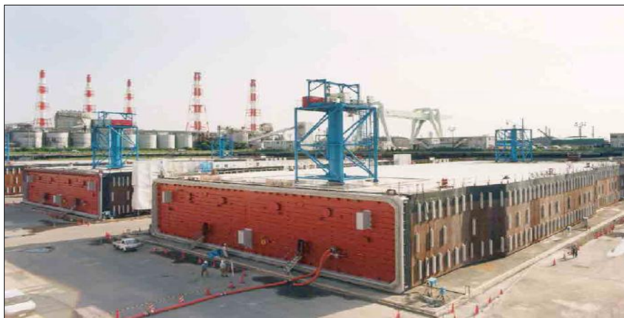
شکل ۲-۴: بتن‌ریزی با بتن خودتراکم برای سازه‌های ساندویچی تونل غوطه‌ور در Kobe ژاپن [۱۰]
