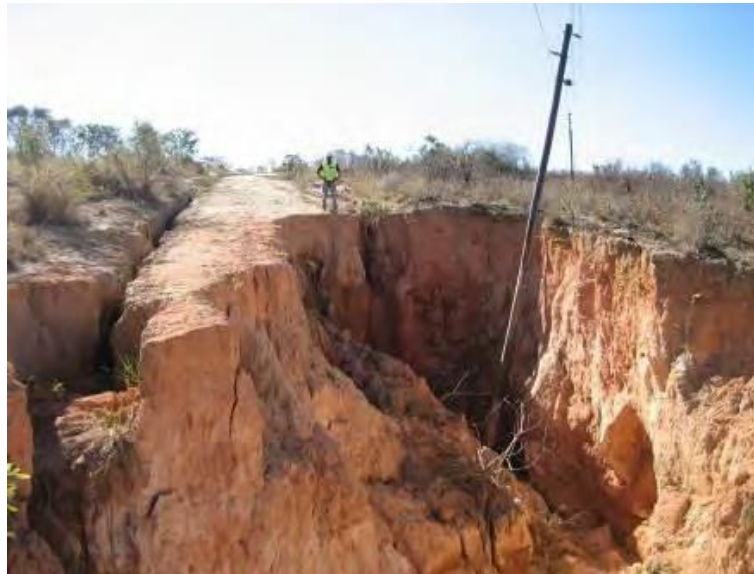
شکل (۲-۳) : فرسایش بر اثر پدیده واگرایی [۳۸].
