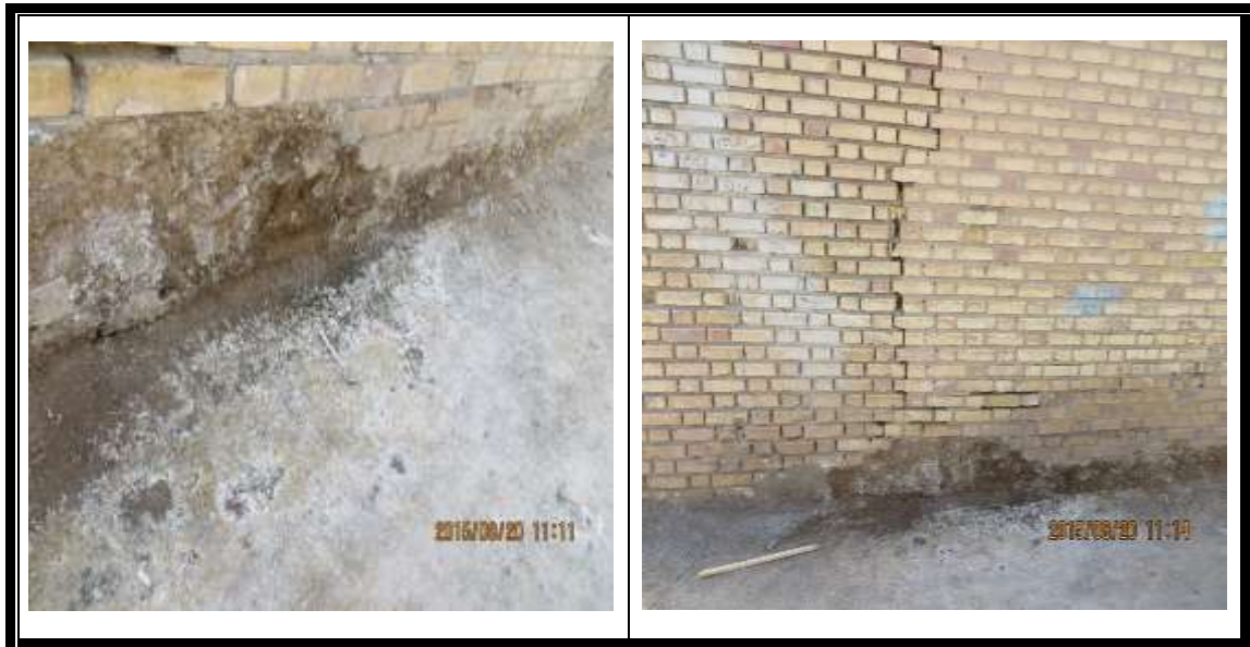
شکل ۳-۴: ترک و خرابی دیوار
