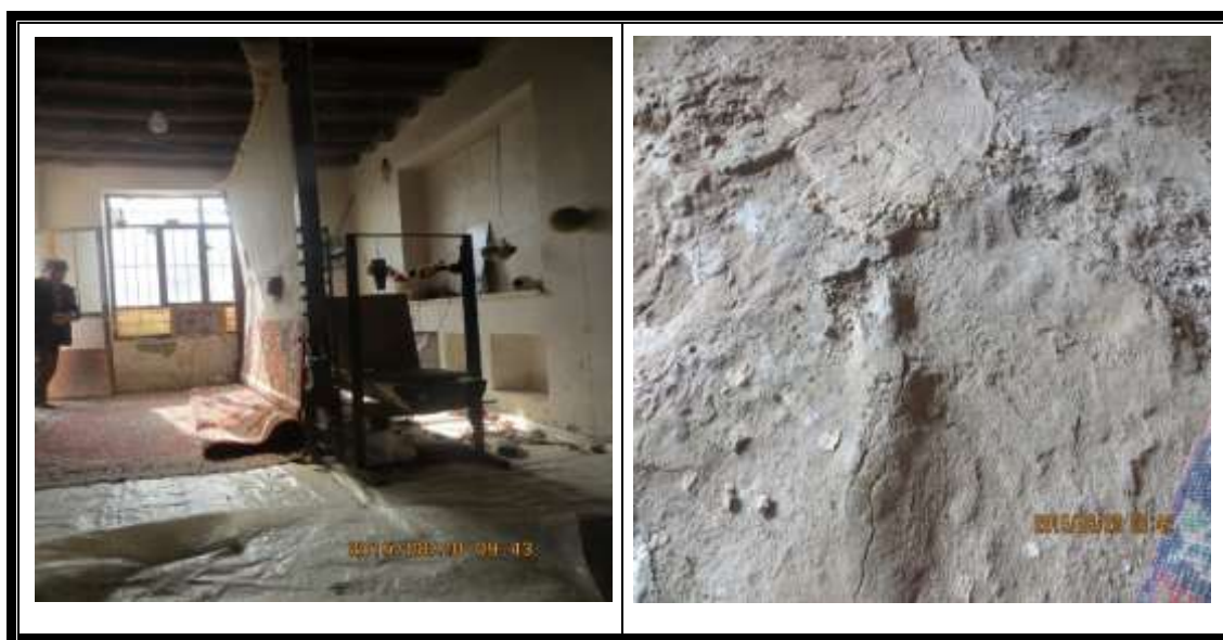
شکل ۳-۳: خرابی کف بر اثر بالا آمدگی
