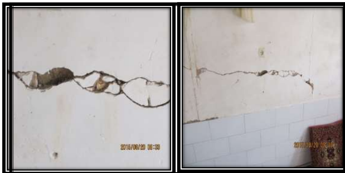
شکل ۲-۳: ترک ناشی از نشست ساختمان
