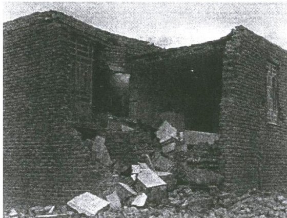
شکل (۶-۱) خرابی در گوشه یک ساختمان آجری (زلزله بم ۱۳۸۲)
