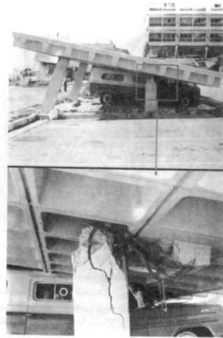
شکل ۲-۲- تخریب پارکینگ آمبولانس‌ها (ساختمان جانبی) [۱]
