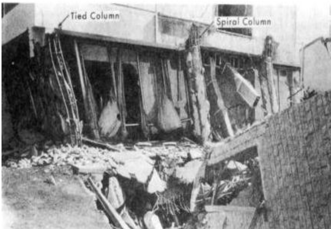
شکل ۱-۲- ستون‌های تخریب شده در ساختمان اصلی [۱]
