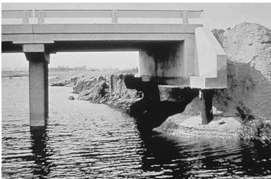
شکل (۲-۵) فرسایش جداره و بستر رودخانه در اطراف تکیه‌گاه پل در یک رودخانه
