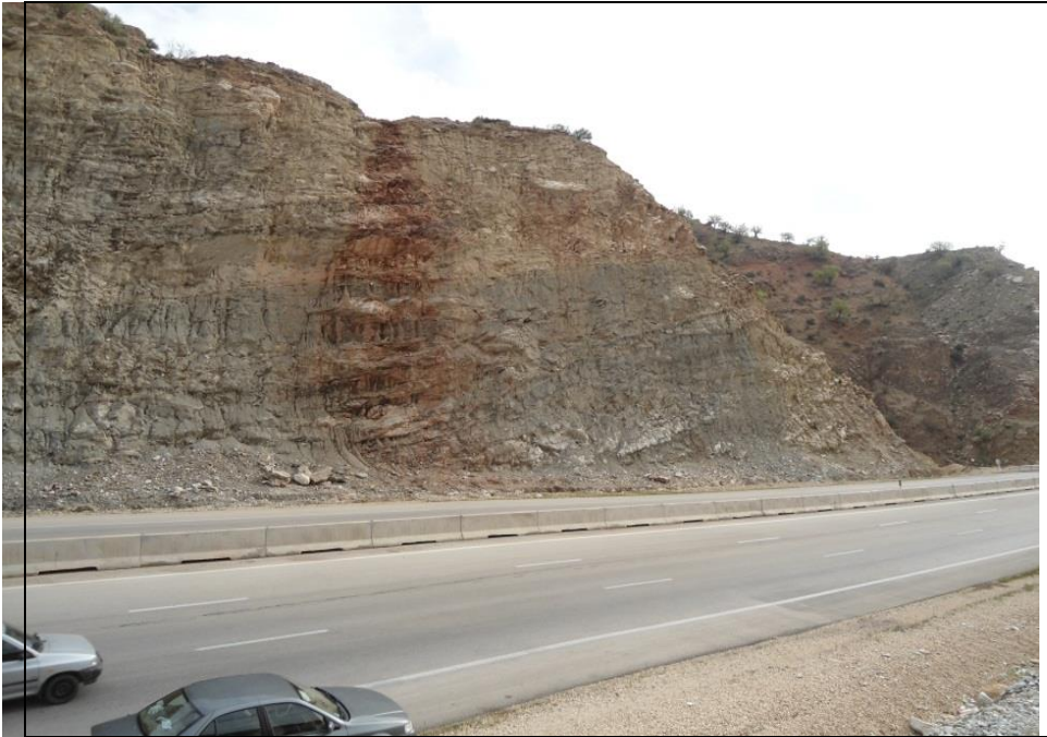
شکل (۳-۱۳) - ترانشه احداث شده در سازند گچساران که حالتی پایدار را نشان می‌دهد ولی با توجه به شواهد و جنس لایه‌ها احتمال ناپایداری در آینده به علت آبیگری مارن‌های موجود پیش‌بینی می‌شود (ایستگاه شماره ۳).
