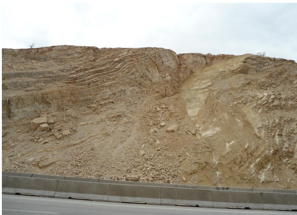
شکل (۳-۲۲)- لغزش گوه‌ای تیپیک در سازند آسماری (ایستگاه شماره ۱۲)
