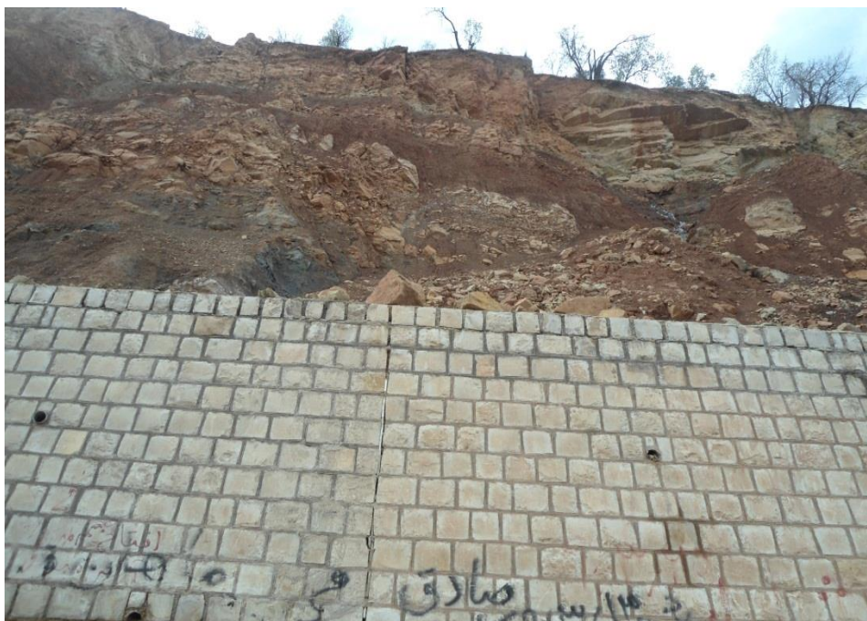
شکل (۳-۱۵) - ریزش سنگی در سازند آغاچاری (ایستگاه شماره ۵)
