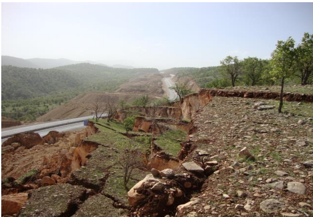
شکل (۳-۲۱)- بزرگترین لغزش رخ داده در طول مسیر که شامل لغزش‌های بلوکی چرخشی و مرکب (عمق لغزش تا کف) در میان سازند آسماری می‌باشد. در این منطقه بلوک‌های بزرگ سنگی لغزش یافته در طول مسیر مشاهده می‌شود (ایستگاه شماره ۱۱).
