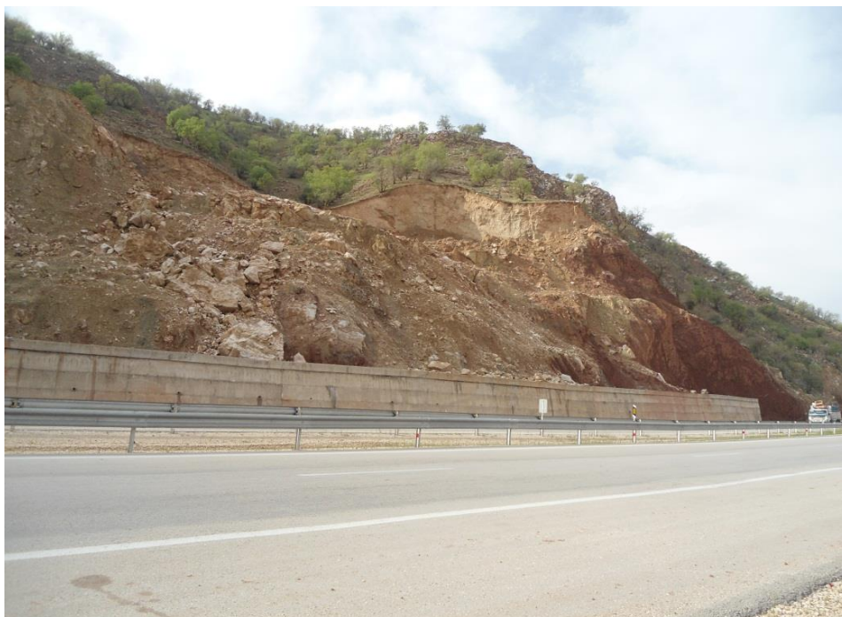
شکل (۳-۱۶) - پهنه لغزشی بزرگ با احتمال خطر لغزش‌های بزرگ و ریزش در سازند گچساران (ایستگاه شماره ۶)
