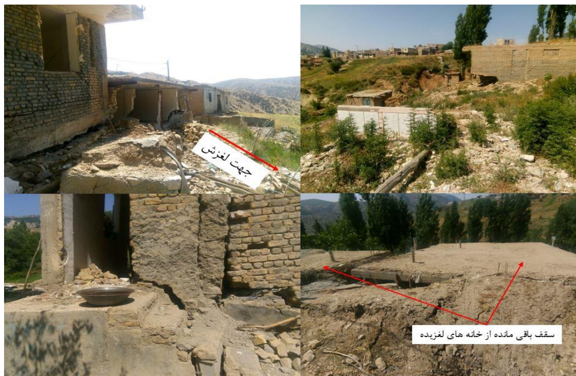
شکل ۴-۲۷: تصاویری از خانه‌های تخریب شده و لغزیده در پروفیل A
