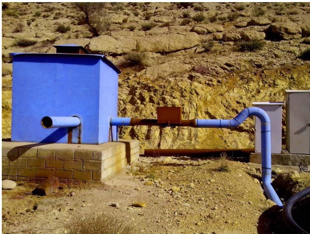
شکل ۳-۱- نمایی از چاه شماره ۳ منصورآباد
