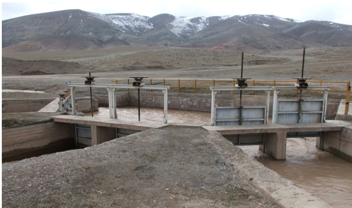
شکل ۱-۷- نمایی از حوضچه کنترل سهراهی طرح تغذیه مصنوعی خوی
