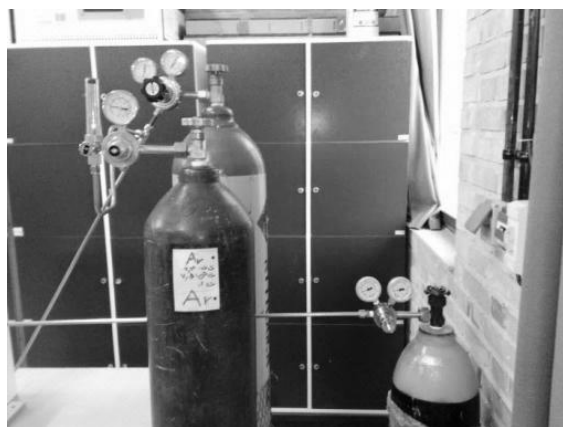
شکل ۳-۲: تصویر کپسول های ازت، آرگون و آمونیاک به همراه رگلاتورهای نصب شده.
