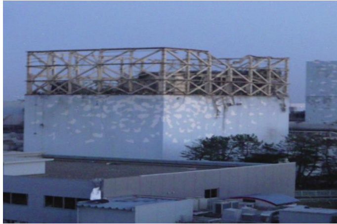
شکل ۳-۱۰: ساختمان آسیب دیده‌ی واحد ۱ نیروگاه فوکوشیما [۱۹]
