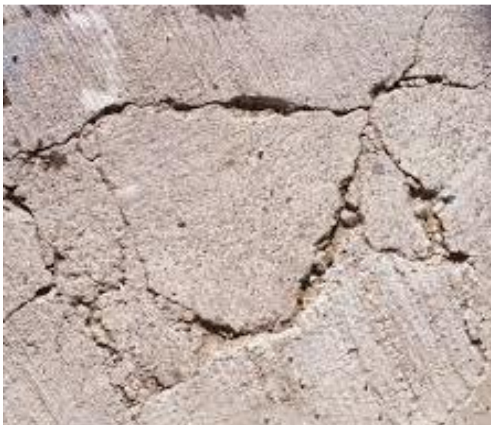
شکل (۱-۳) نمونه‌ای از یک بتن بی‌کیفیت که به علت دارا بودن حفره‌های متعدد ترک‌دار شده است.
