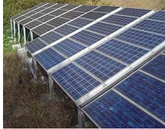
تصویر شماره 2-9: آرایه فتوولتائیک
