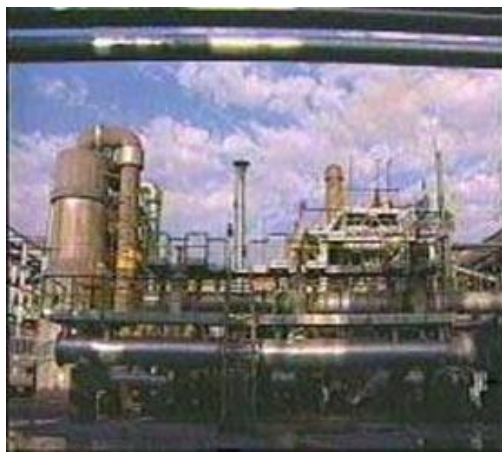
شکل ۲-۱۲: کارگاه پالایش بنزول شکل
