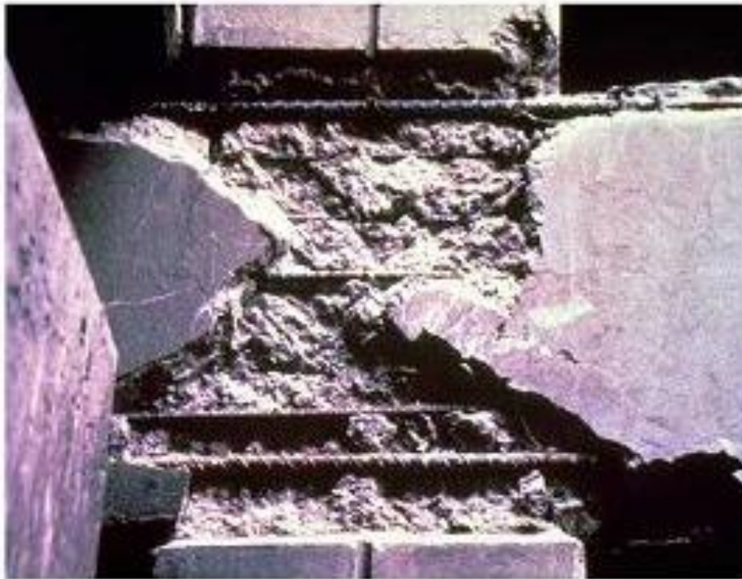
شکل ۸-۶-۲ کمانش میلگردهای طولی تیر در ناحیه اتصال
