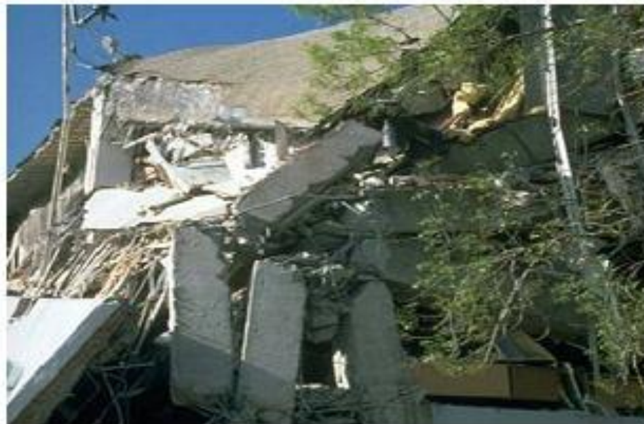
شکل ۲-۶-۵ نمونه‌هایی از شکست در اتصالات ضعیف بتنی
