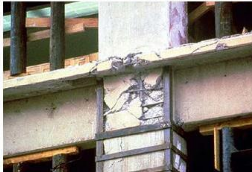
شکل ۲-۶-۷ کماتش میلگردهای طولی ستون در ناحیه اتصال
