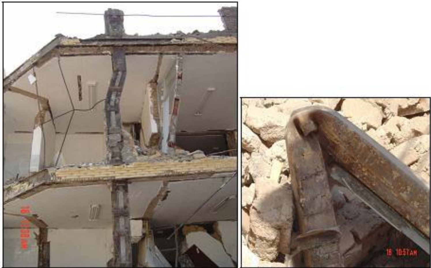
شکل ۲-۵-۳- نمونه ای از خرابی ستون های فولادی
