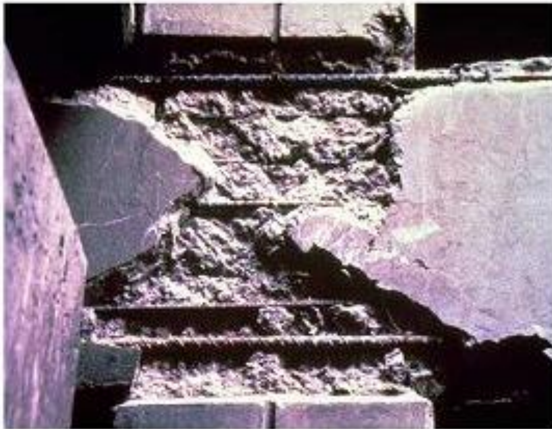
شکل ۸-۶-۲ کمانش میلگردهای طولی تیر در ناحیه اتصال
