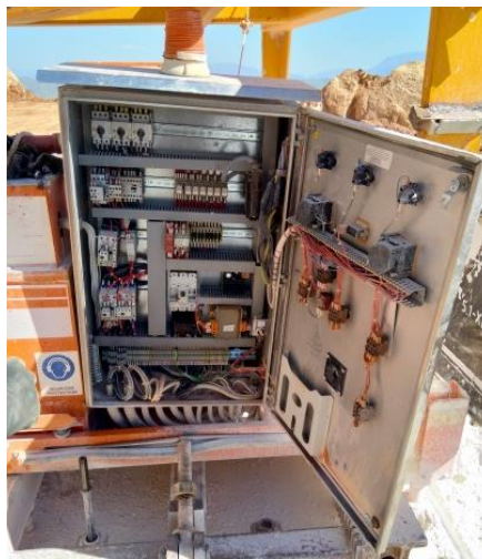
شکل ۲-۱۱: تابلوی برق ماشین و کلیدهای کنترلی
