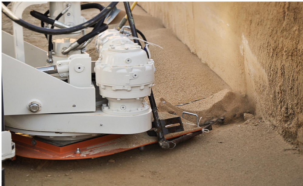
شکل ۲-۲۲ برش افقی در استخراج معادن سنگ ساختمانی به روش ماشین برش اره زنجیری
