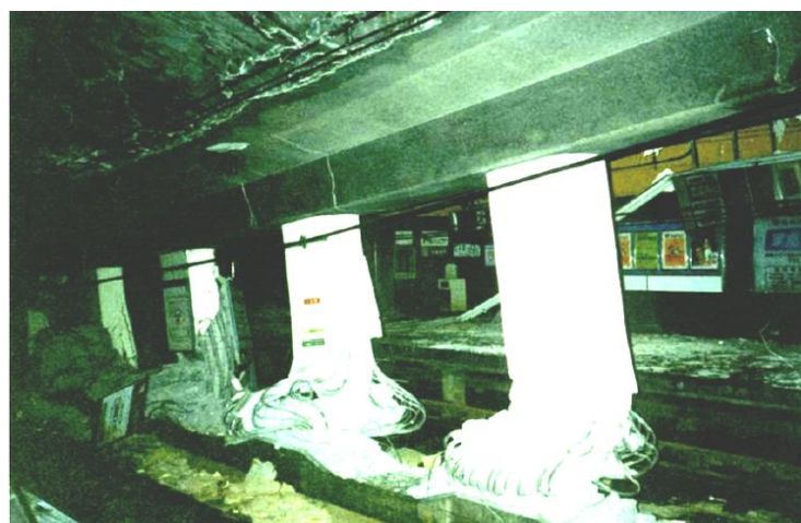
شکل ۱-۲: ستون‌های آسیب دیده ایستگاه مترو (مصطفوی مقدم و آشتیانی، ۱۳۹۱)
