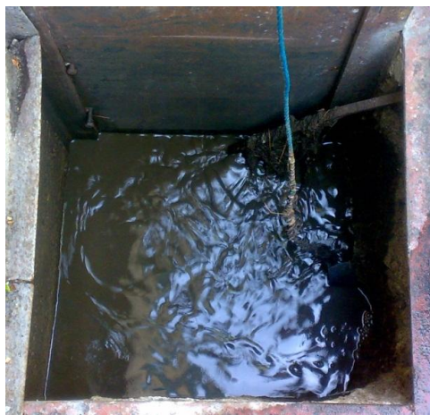
شکل ۴-۶: حوضچه برگشتی لجن فعال تصفیه خانه قیطریه
