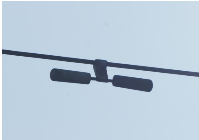
شکل ۱-۱: استفاده از جاذب ارتعاشی در کابل‌های فشار قوی
