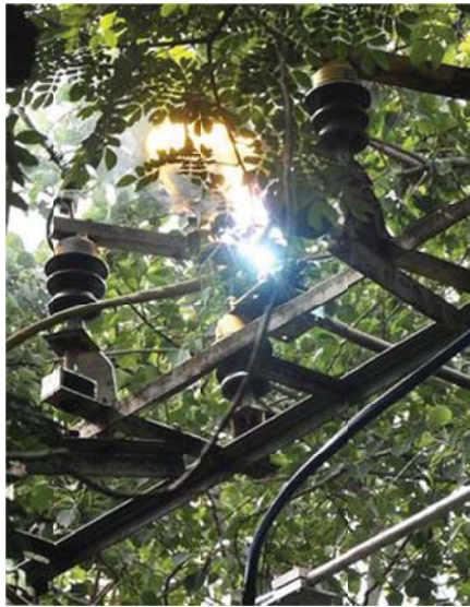
شکل (۱-۱) نمایی از نزدیک شدن درخت به خطوط انتقال برق [۴]
