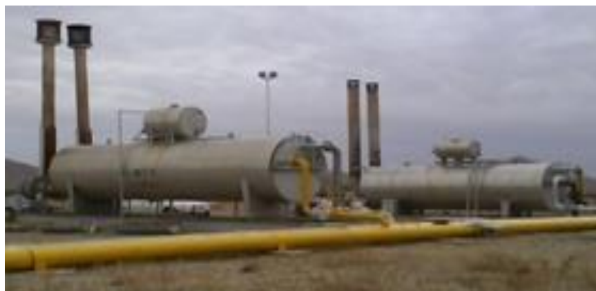
شکل ۳-۳- نمای از دو هیتر ایستگاه CGS
