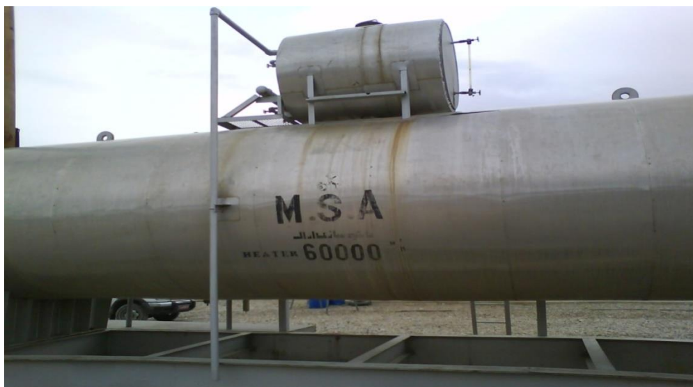
شکل ۳-۴- نمای نزدیک از هیتر ایستگاه CGS
