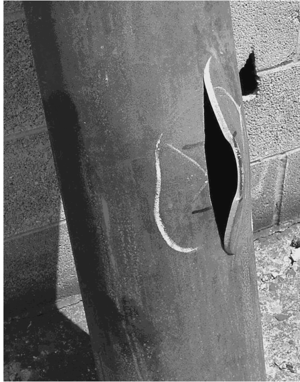
شکل (2-4): خرابی ناشی از یک ترک طولی در یک مخزن تحت فشار
