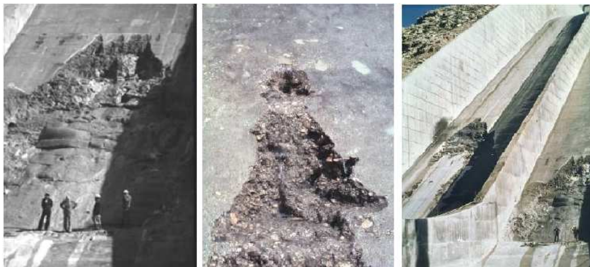
شکل ۳-۱ خسارت کاویتاسیون در سرریز سد کارون یک (شهید عباسپور)
