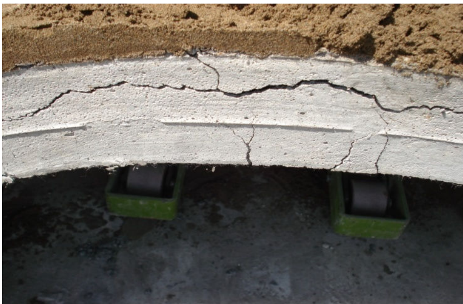
شکل ۳-۲۲ نمای ترک حاصل از بارگذاری
