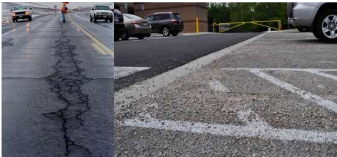
شکل ۲-۲- نمونه‌هایی از خرابی‌های ناشی از عریان شدگی
