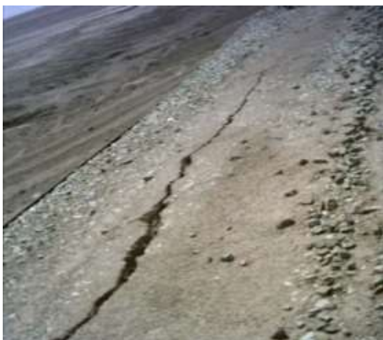
شکل (۳-۱۷) وجود ترک در زیرسازی بلاک سمنان - میان دره
