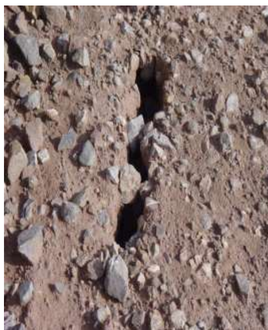
شکل (۲۲-۳) نشست و رانش و گسیختگی خاکریز خط در
