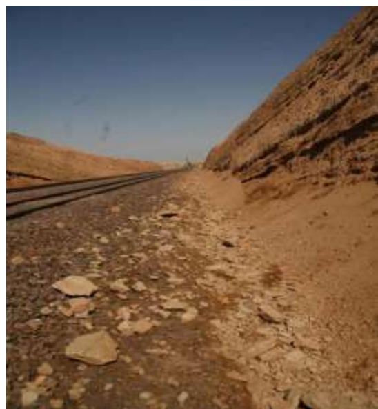
شکل (۳-۱۴) عدم احداث کانال در داخل شکل ترانشه و نیز ضرورت شیرین چشمه - گیلان
