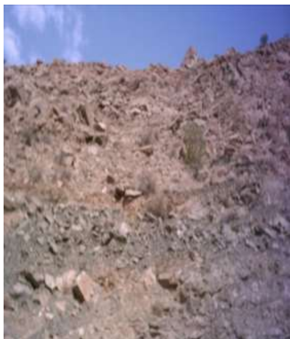
شکل (۲۳-۳) ریزشی بودن ترانشه مشرف به خط سمنان - میاندره
