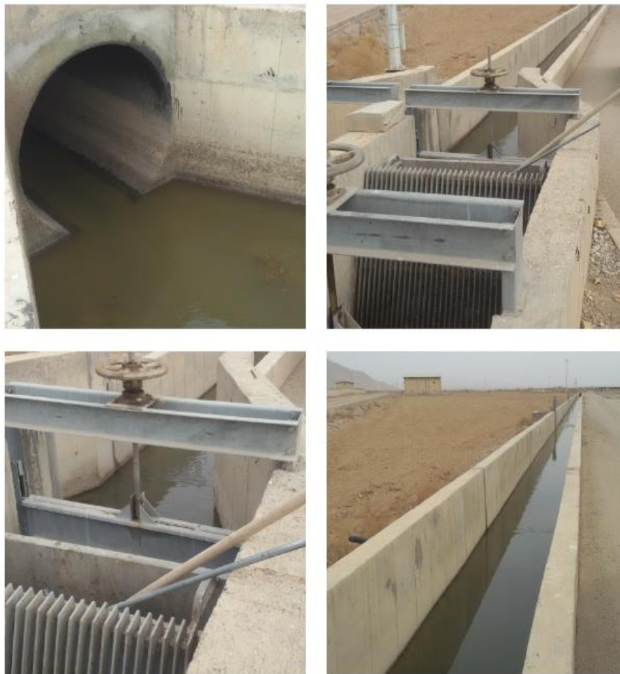
شکل ۳-۲ قسمت ورودی تصفیه‌خانه بعد از آشغالگیرها
