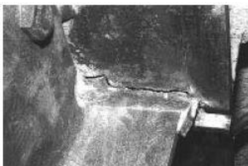
(الف) شکست روی سطح جوش
