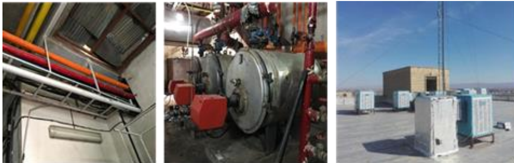
شکل ۳-۱۱. تاسیسات گرمایشی و سرمایشی ساختمان مرکز کامپیوتر، ماخذ: نگارنده.
